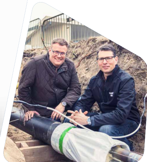
Fjärrvärmeinkoppling för Åhus Seaside.
